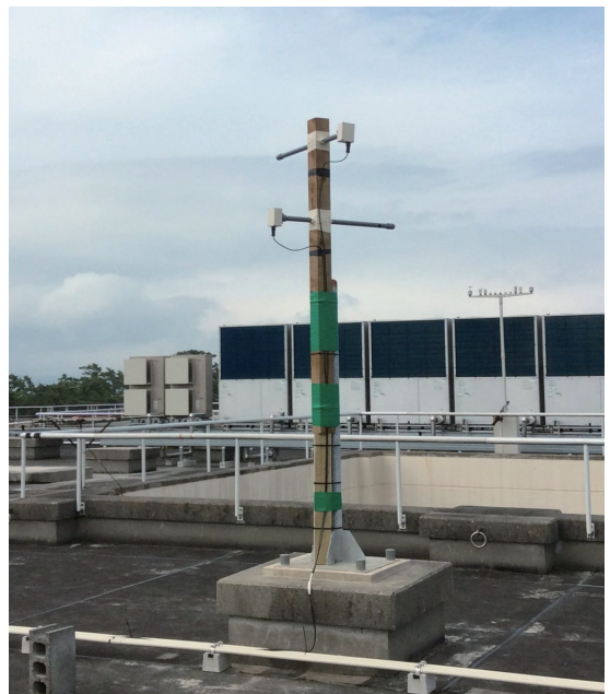
図6 清水校舎 8号館屋上のセンサー.
